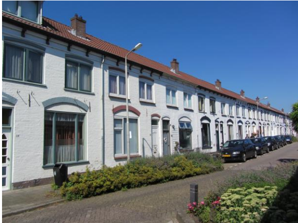
Afbeelding 5: Overzichtsfoto van de woningen aan de De Ruijterstraat, de kalkzandsteengevels zijn geheel voorzien van een verflaag.
