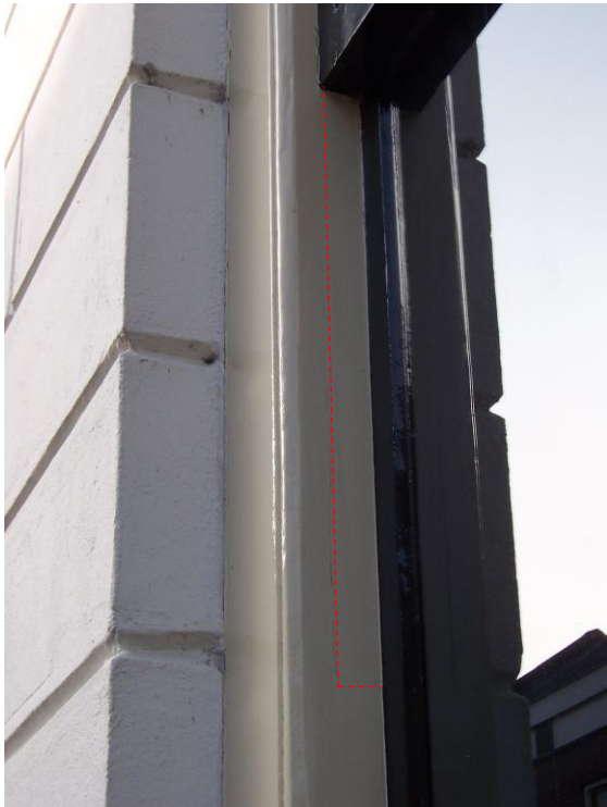
Afbeelding 2: stopstuk in dagkant kozijn, moeilijk op foto vast te leggen, het beste is om zelf te gaan kijken
